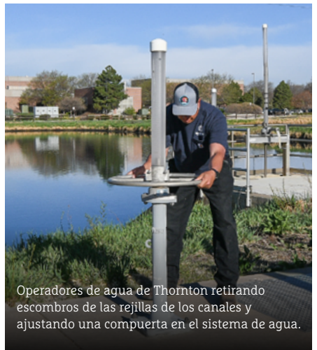
Operadores de agua de Thornton retirando escombros de las rejillas de los canales y ajustando una compuerta en el sistema de agua.
